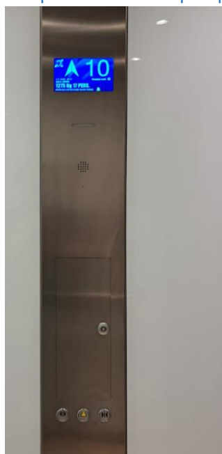
COP avec boîte à bouton mécanique cachée pour manœuvre pompiers
