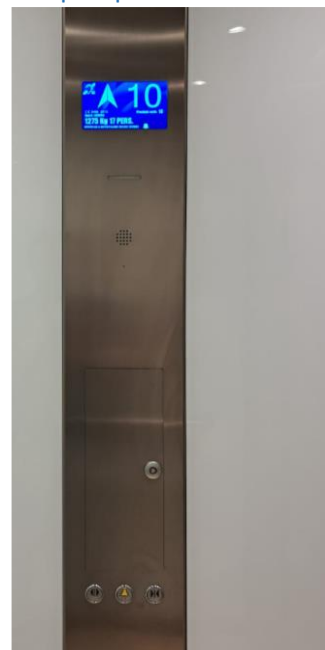
COP con pulsantiera meccanica per manovra pompieri in nicchia
